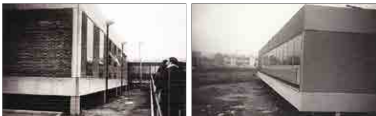
INTA Castelar. Los laboratorios en construcción. En a) alumnos recorriendo las futuras instalaciones.
